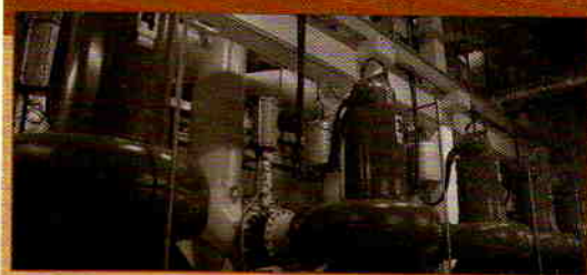
Pompes automatisées de la station de pompage Mazas
