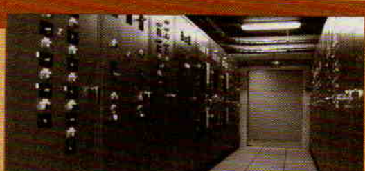
Local des automates de la station Mazas
