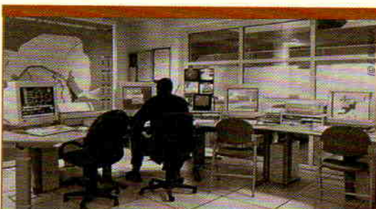
Afin d'optimiser l'écoulement des effluents, des vannes de répartition ont été installées dans le réseau. Un poste central de contrôle permet de gérer et de télécommander à distance ces équipements.
