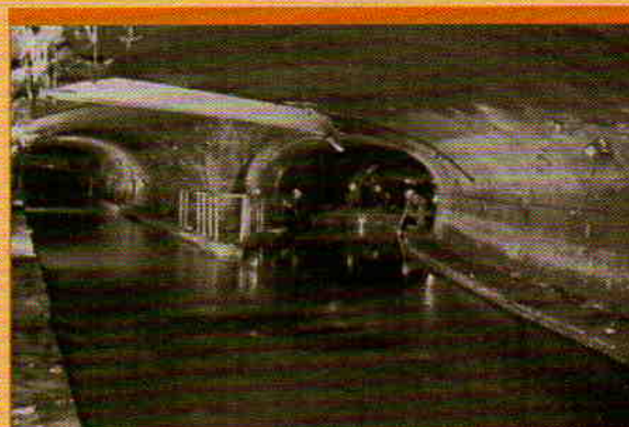
Deux grands collecteurs se rejoignent avant leur arrivée sur l'usine de pompage permanent de Clichy qui évacue les eaux usées vers la station d'épuration Seine aval à Achères
